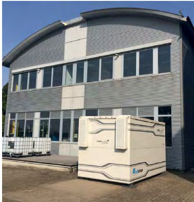
Die Redox-Flow-Batterie vor der Versuchshalle, Foto: Werner Siemers, CUTEC
