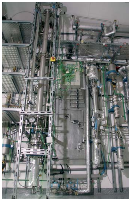
Anlage zur Erzeugung von Fischer-Tropsch-Kraftstoffen
