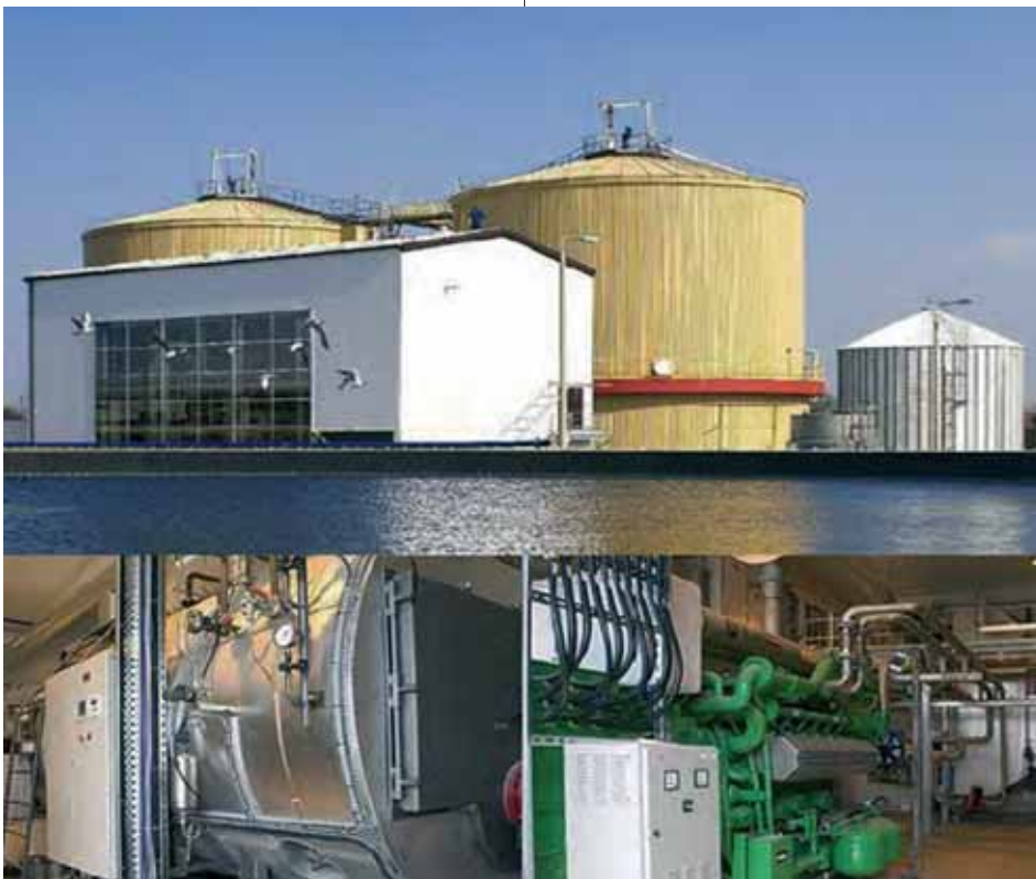
Anlage zur thermischen Hydrolyse nach CAMBI in Bydgoszcz, Polen
