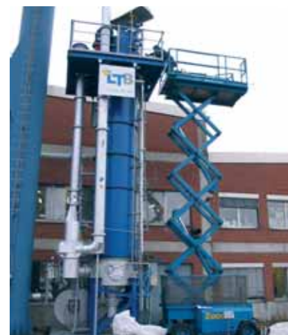
Einsatz der Pilotanlage in Hamburg
