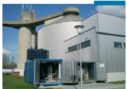
Versuchsanlage zur Eindickung und mechanischen Desintegration
