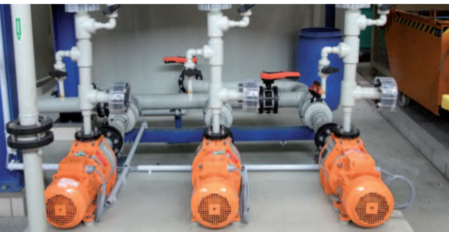
Pumpen zur Kreislaufführung der Zinksäure
