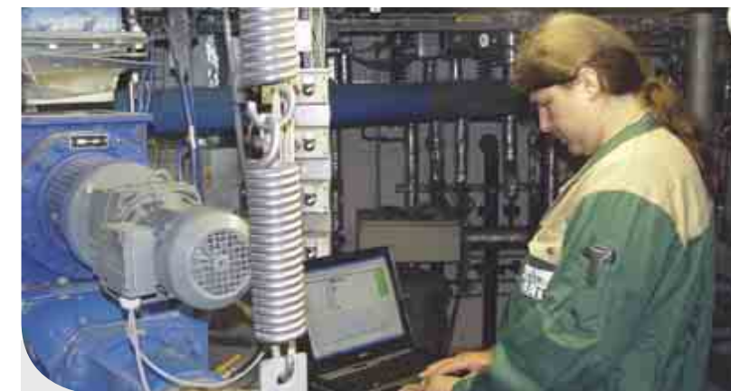
Kontrolle der Anlagen und Erfassen der Messdaten während des Versuchsbetriebs
